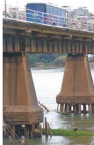
PONTE de Colatina: perigo
